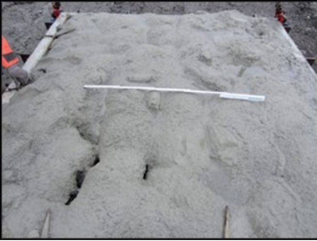
Bild 2: Mangelhafte Vergussstoffverteilung bei Teilverguss (Ablagerung des Materials an der Oberfläche der Deckschicht)
