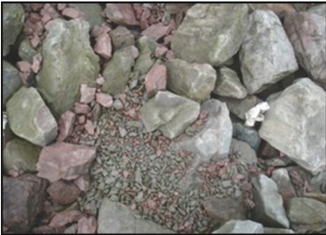
Bild 1: Deckschicht mit lokal frostgeschädigten Wasserbausteinen
